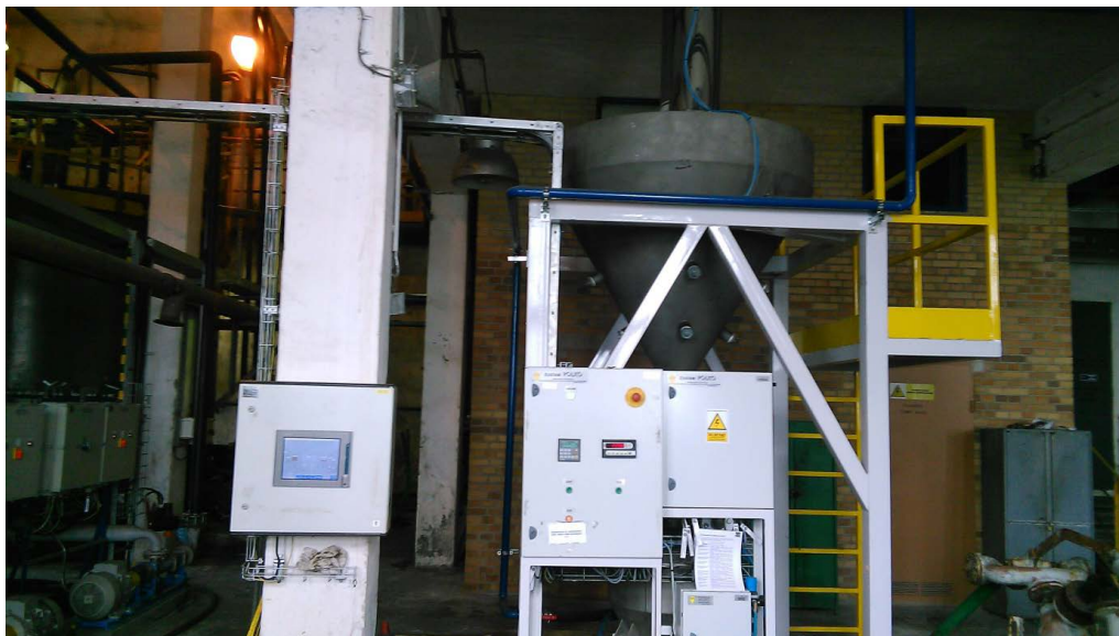
Rys. 5. Panel sterownia układu dozowania i transportu suchego flokulanta
