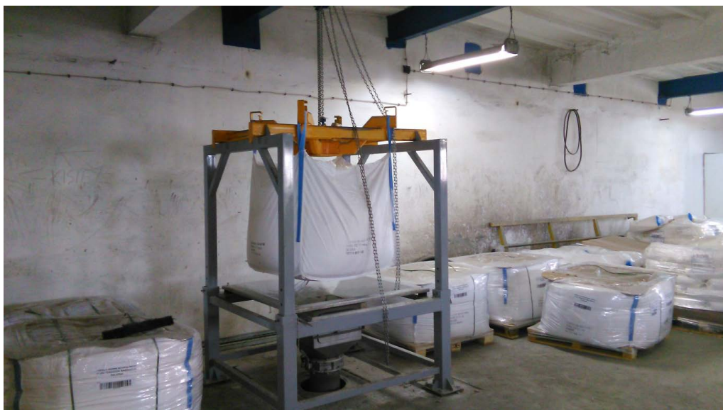
Rys. 4. Stanowisko rozładunku big-bagów
